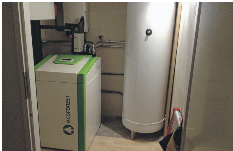
■ Een geïnstalleerde warmtepomp.
